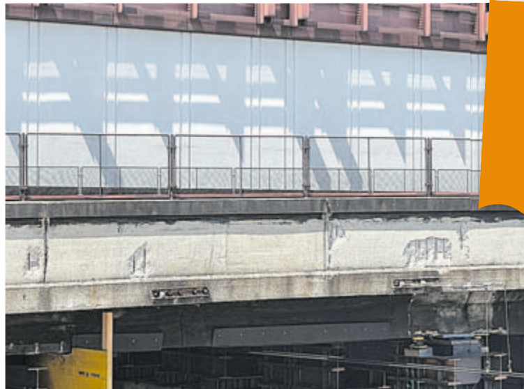
Der Zustand der Peter Merian-Brücke sieht nicht vertrauenswürdig aus. Droht uns bald die nächste Brückensperrung? Foto: Thomas P. Weber
