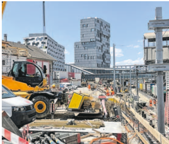
Wo, wann gebaut, gebohrt und betoniert wird, wird seitens der SBB nicht kommuniziert! Fotos: Thomas P. Weber
